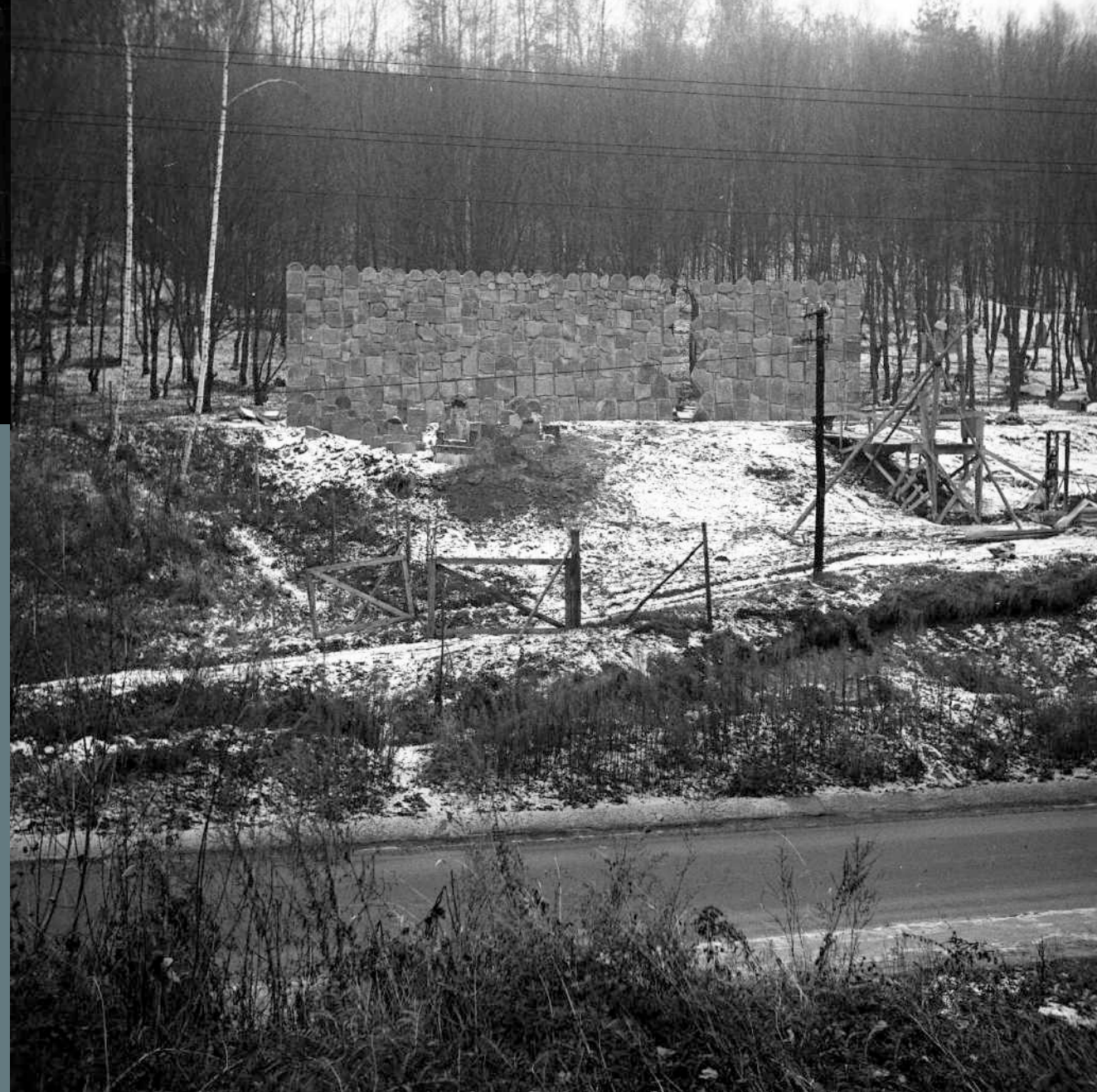
▲ Kazimierz Dolny. Budowa pomnika na cmentarzu żydowskim przy ul. Czerniawy, w miejscu rozstrzelanych Żydów i Polaków, więźniów kazimierskiego Gestapo, fot. A. Moracki, 1984 (zb. MNKD)
