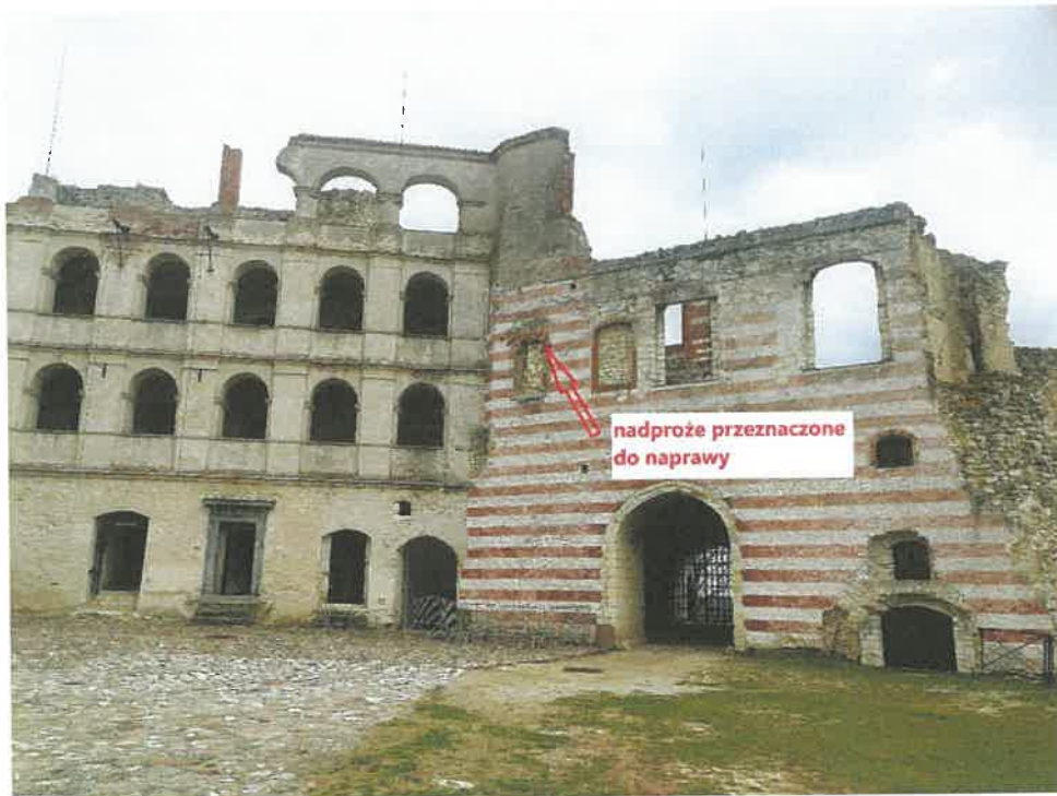
FOT. 18. Nadproże przeznaczone do naprawy
