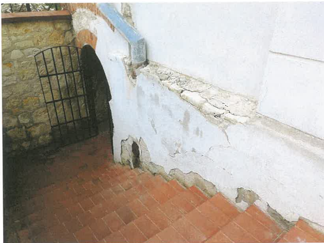
FOT. 25. Uszkodzony tynk przy schodach do wc
