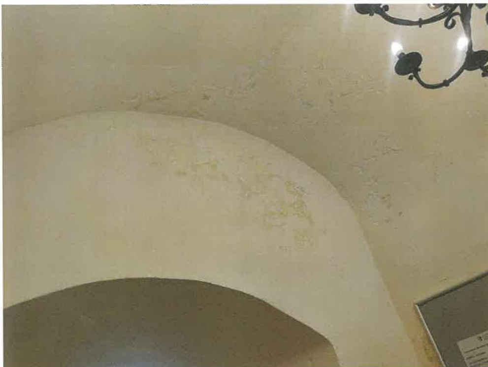
FOT. 34. Tynk przeznaczony do naprawy
