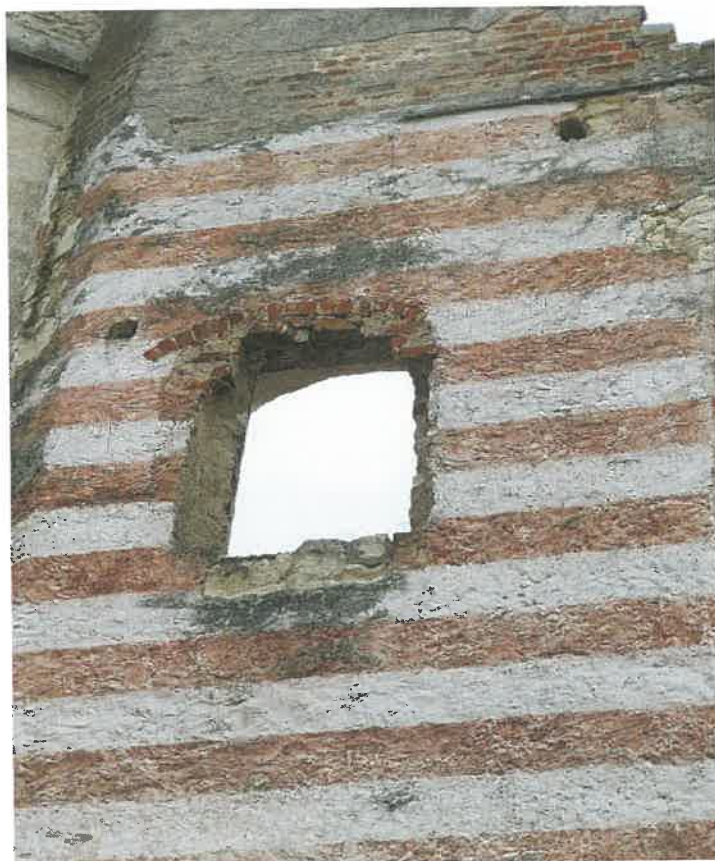
FOT. 19. Uszkodzone nadproże przeznaczone do naprawy
