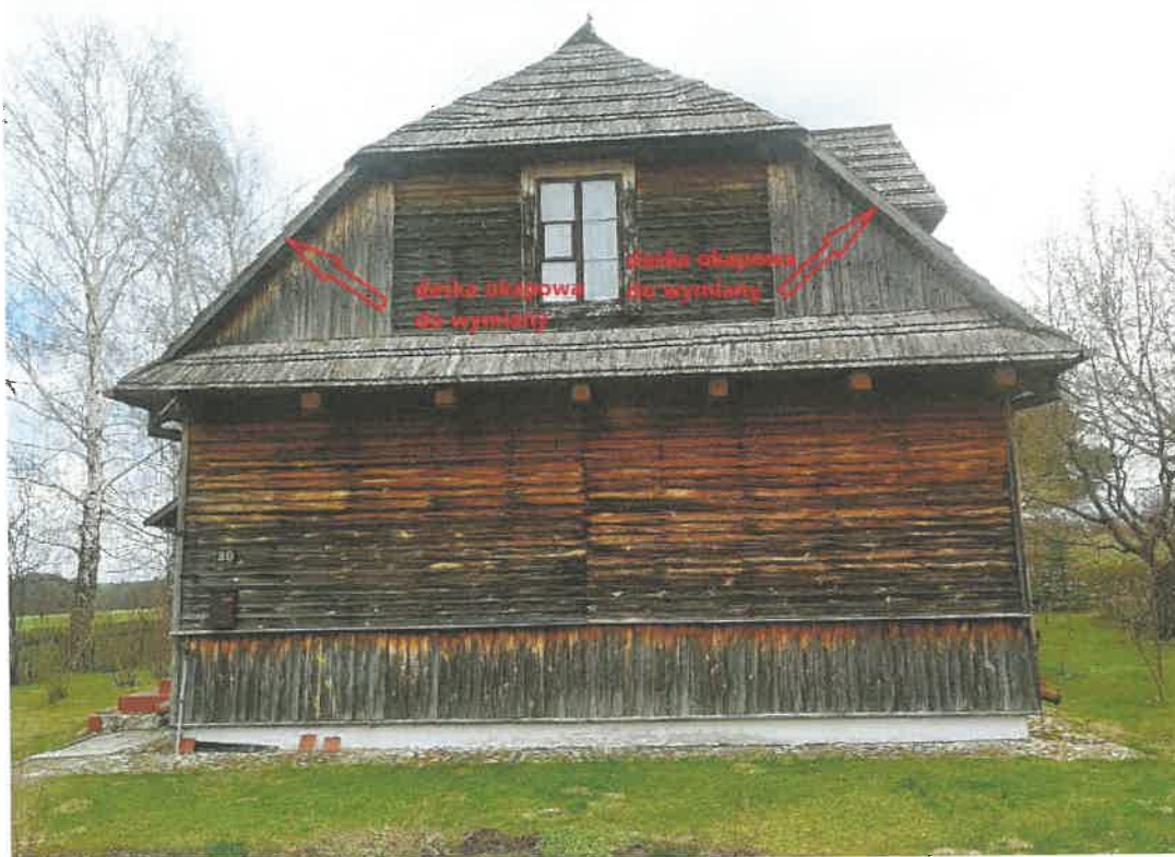
FOT. 14. Deski okapowe do wymiany od strony zachodniej
