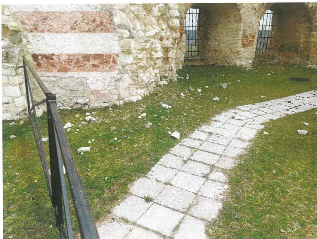
FOT. 21. Spadające kamienie z muru
