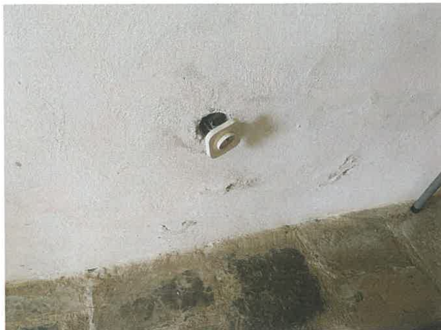
FOT. 30. Uszkodzone gniazdo elektryczne
