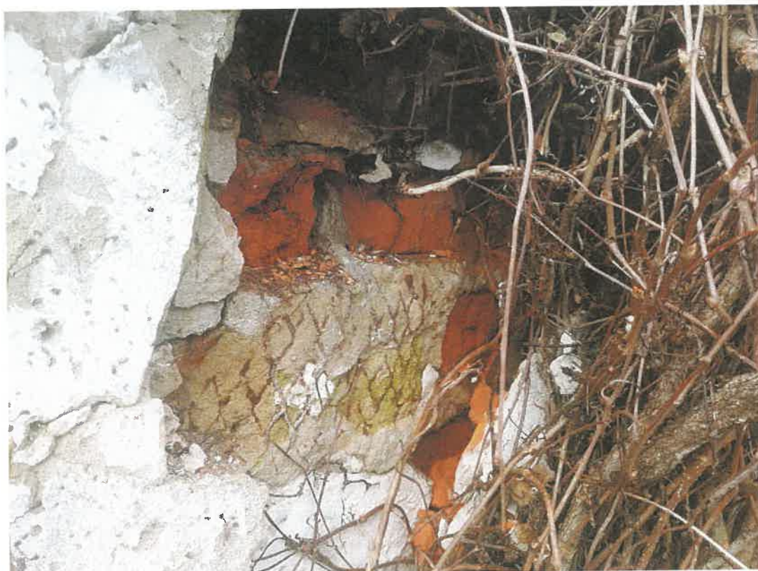
FOT. 6. Wykruszone cegły tarasu
