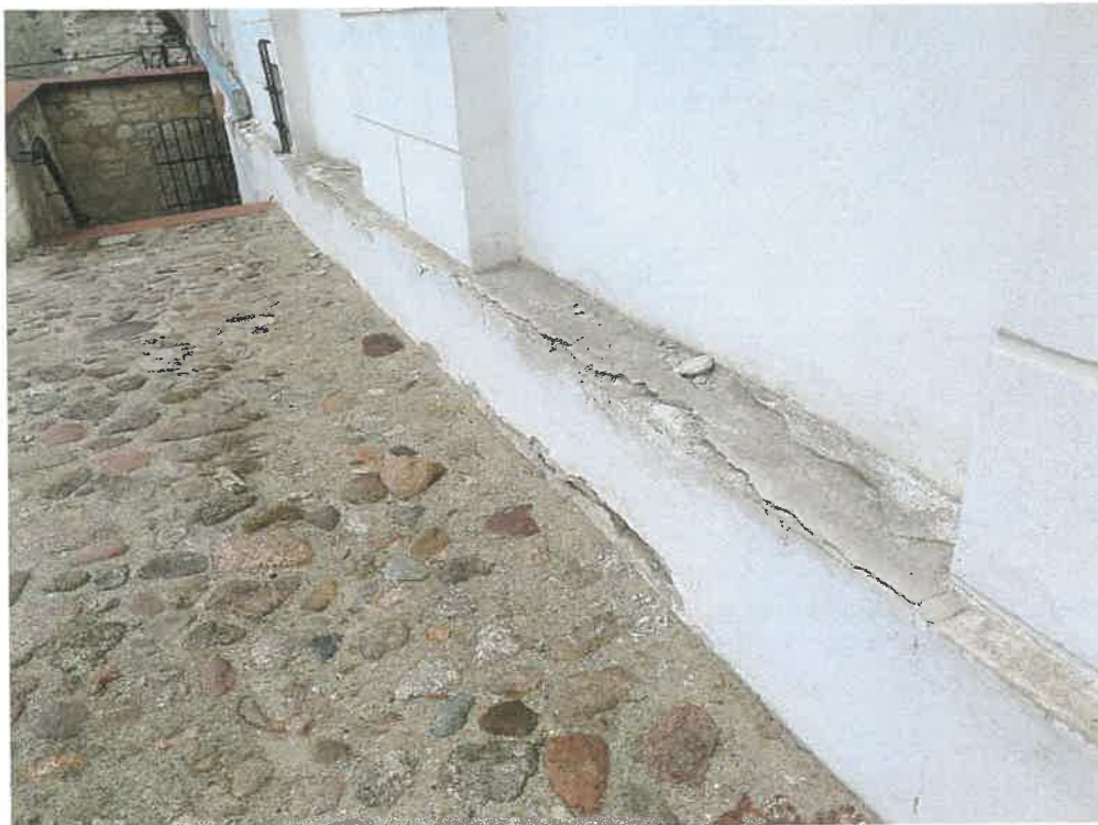
FOT. 24. Uszkodzony tynk na cokole
