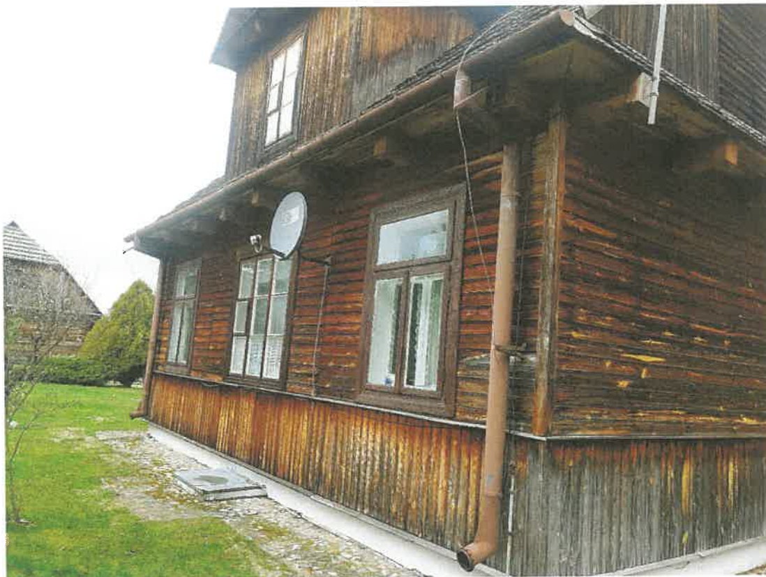
FOT. 13. Nieszczelne i skorodowane orywnowanie od strony południowej
