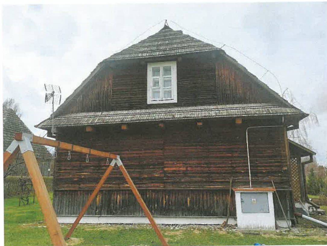
FOT. 15. Deski okapowe do wymiany od strony wschodniej
