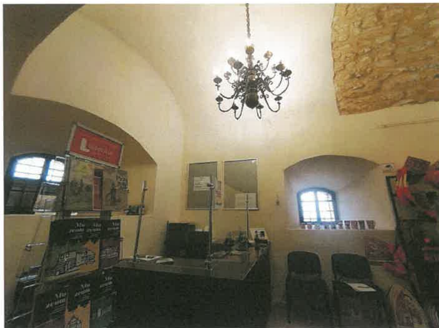
FOT. 35. Tynk przeznaczony do naprawy
