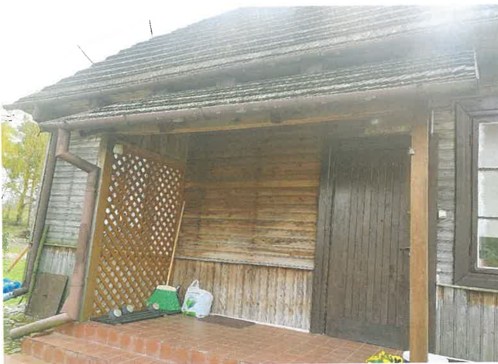
FOT. 11. Nieszczelne i skorodowane orywnowanie od strony północnej
