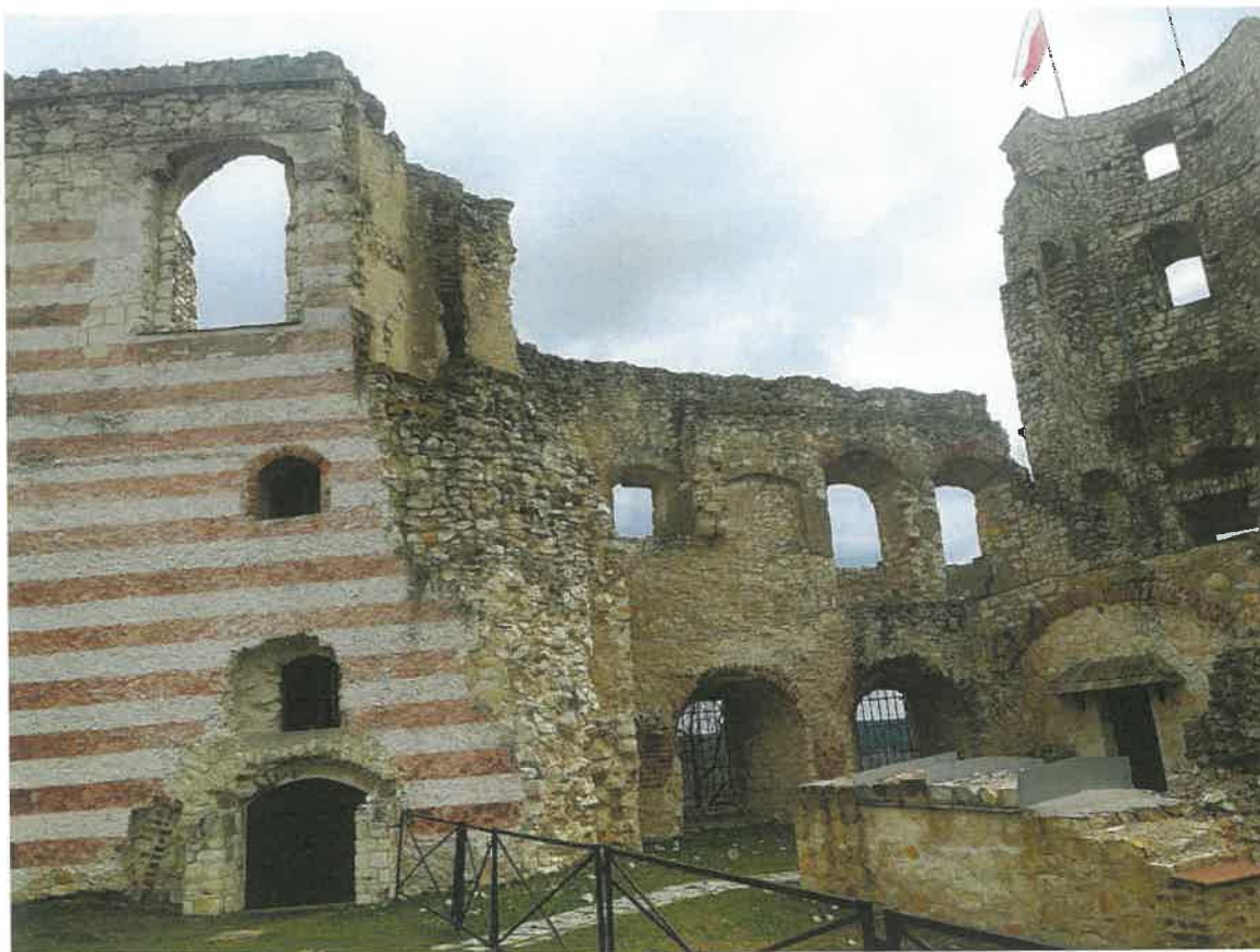
FOT. 20. Mur przeznaczony do zabezpieczenia przed spadającymi kamieniami
