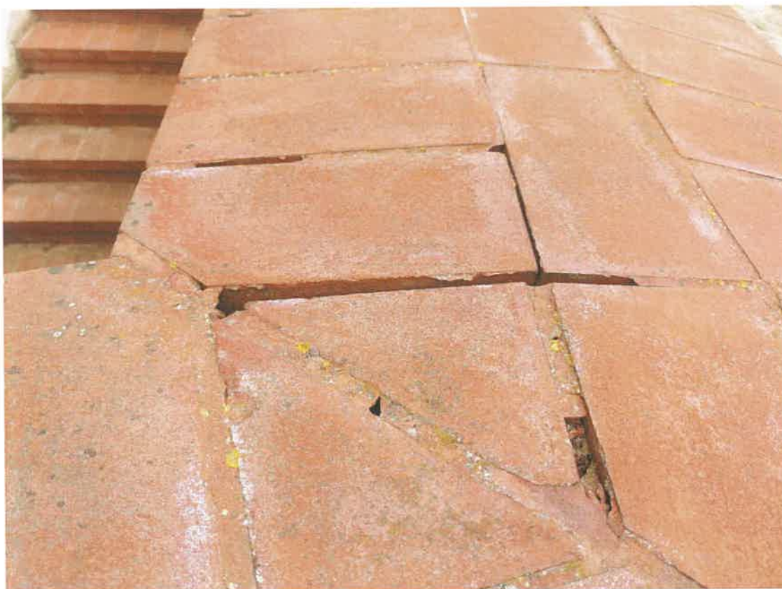
FOT. 27. Uszkodzone fugi na murku
