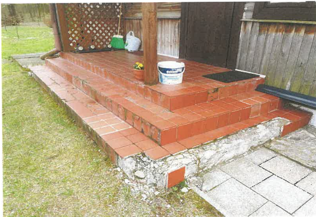
FOT. 16. Schody przeznaczone do naprawy od strony północnej
