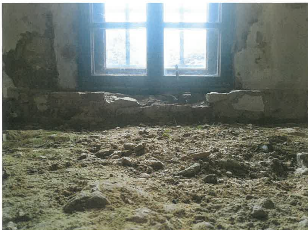
FOT. 33. Nieszczelne połączenie okna z murem
