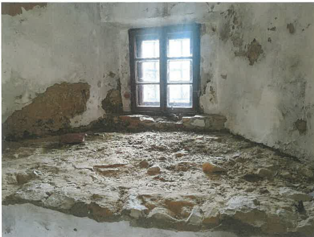
FOT. 32. Zanieczyszczony parapet
