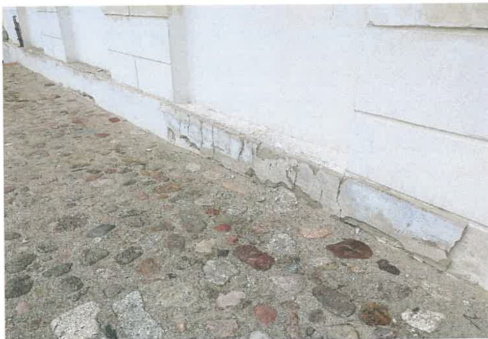
FOT. 23. Uszkodzony tynk na cokole
