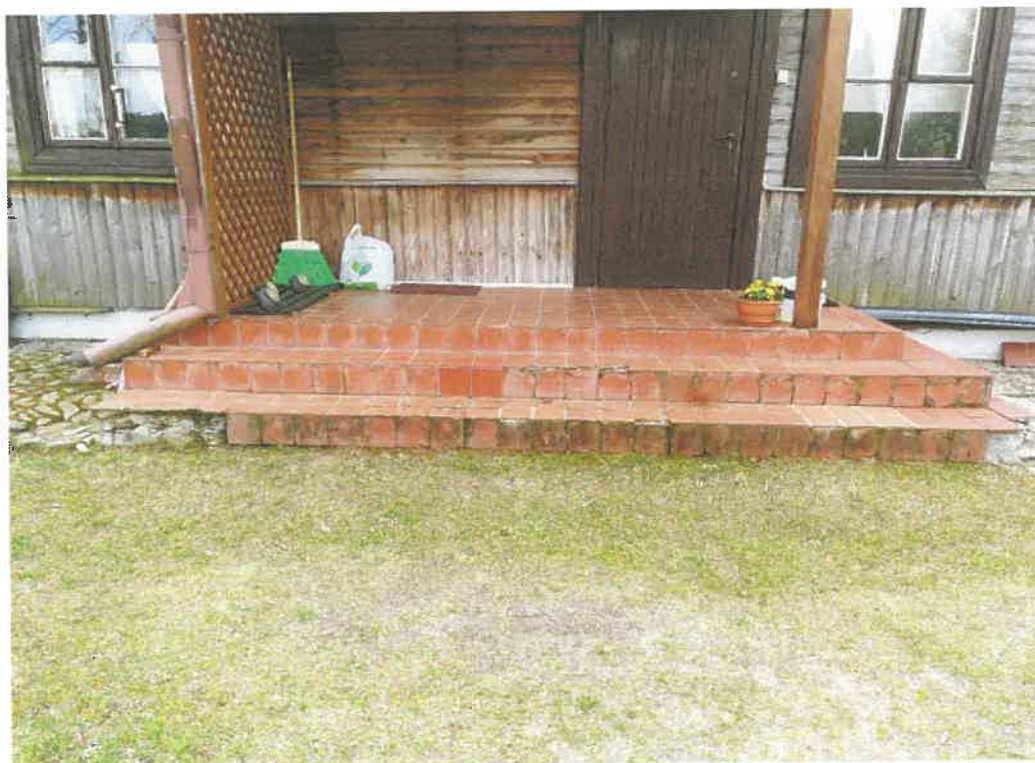
FOT. 17. Schody przeznaczone do naprawy od strony północnej
