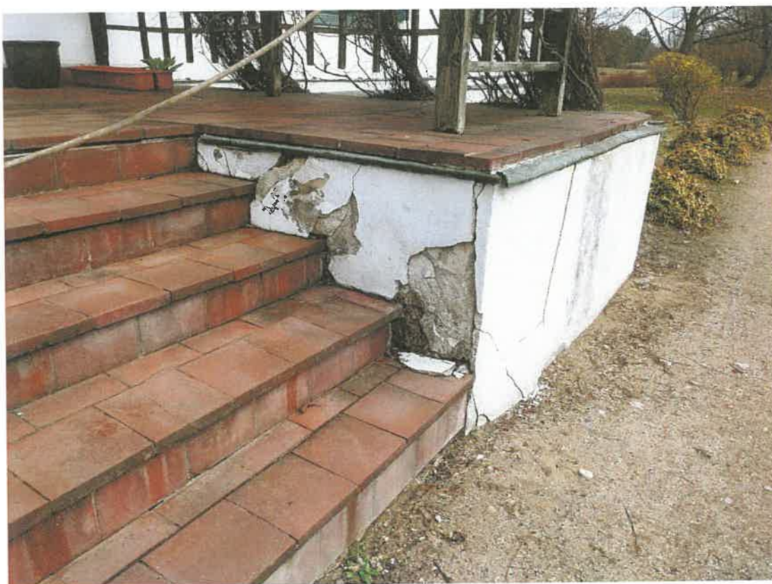
FOT. 7. Odpadający tynk ścian tarasu
