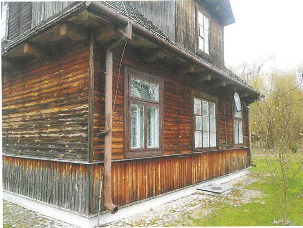
FOT. 12. Nieszczelne i skorodowane orywnowanie od strony południowej
