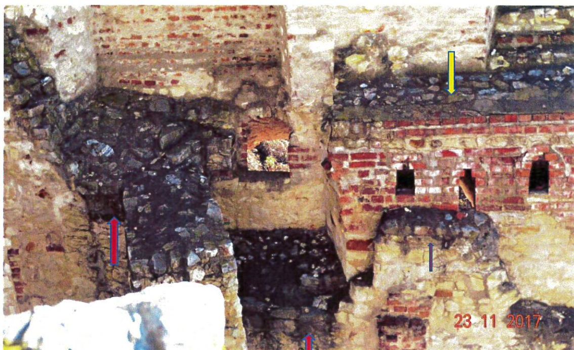
Fot. 39Seksja B korony strzędów murów z widocznymi licznymi zniszczeniami w obrębie przemurowań (żółta strzałka) i poniżej w wątku kamiennym (czerwona strzałka).
