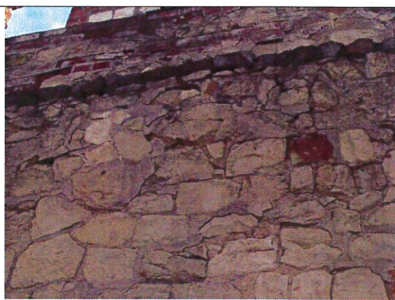
Fot. 18/B. Uszkodzenia muru z opoki wapnistej pod pasem z kwarcytu.
