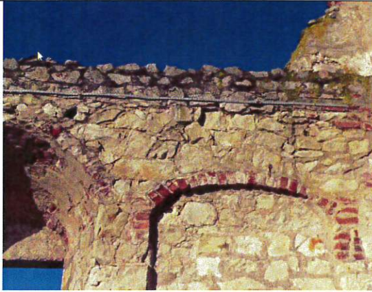
Fot. 21/B. Uszkodzenia muru z opoki wapińskiej pod pasem z kwarcytu.
