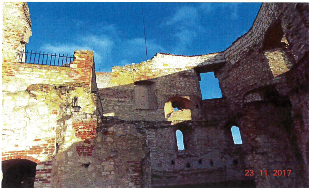
Fot. 40Sekcja A, widoczne pozostałości tynków w glicach okiennych i w ich przemurowaniach.
