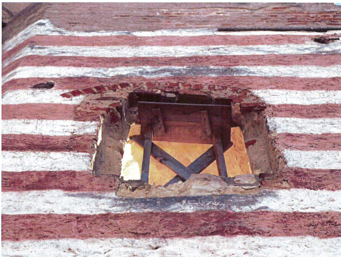
Fot. 42 Sekcja C, zachowany otwór okienny z XVI w, widok od strony dziedzińca, widoczne gniazda po blokach kamiennych obramienia. Dony fragment zachowany w złym stanie.
