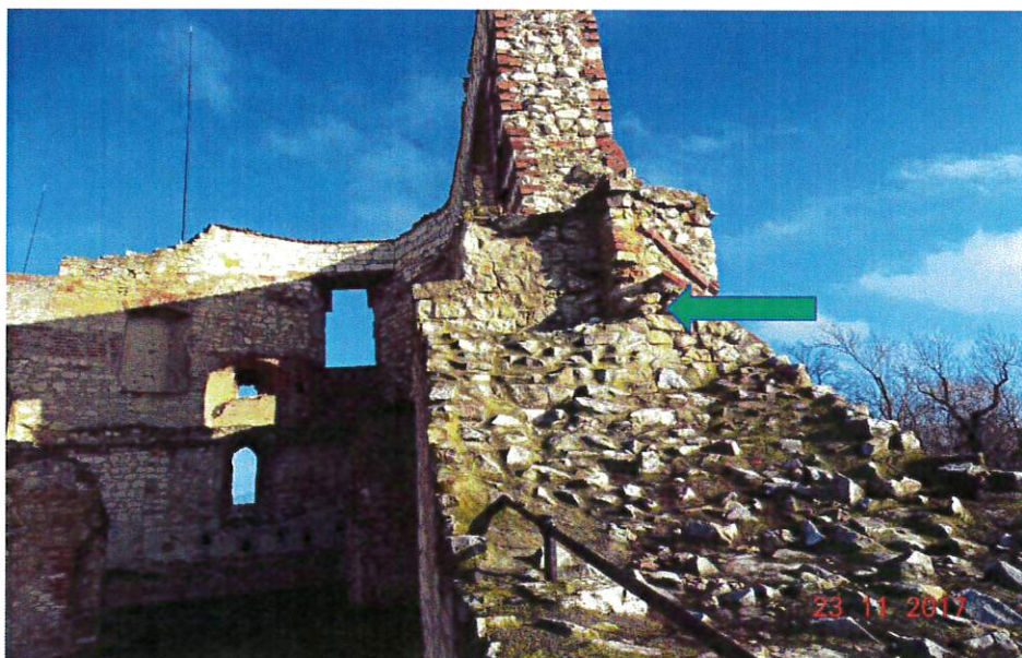
Fot. 38Sekcja B, fragment przemurowania kwarcytowego w formie spływu. Widoczna korozja biologiczna i nieliczne uszkodzenia. Fragment otworu strzelniczego Zielona strzałka)
