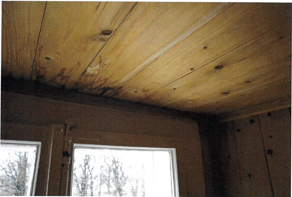
Opis: zapleśniałe deski sufitowe do demontażu
