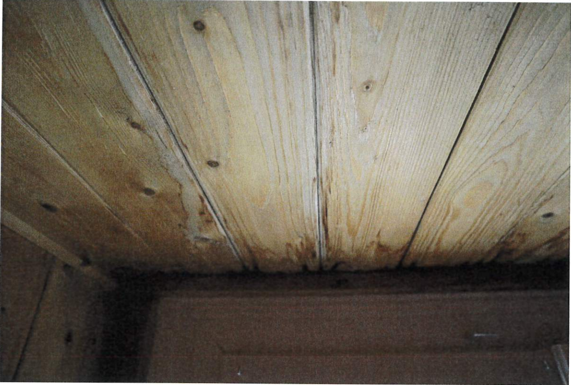
Opis: zapleśniałe deski do demontażu
