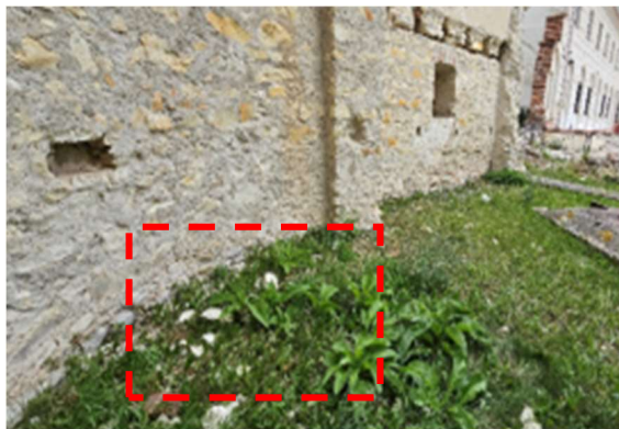
Fotografia 4 Miejsce styku muru z gruntem. Widoczne skruszenia murów.
