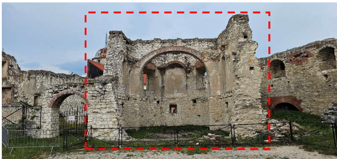
Fotografia 2 Widok na fragment Kaplicy od strony wschodniej. Widoczne spękania i ubytki w materiale murowym, tynku i spoinach.
