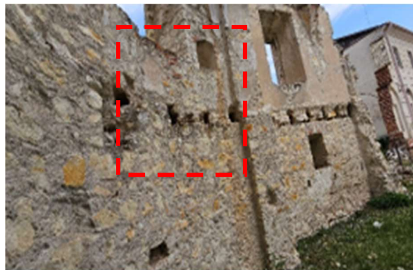
Fotografia 5 Wewnętrzna ściana muru Kaplicy. Widoczne zacieki na murach.
