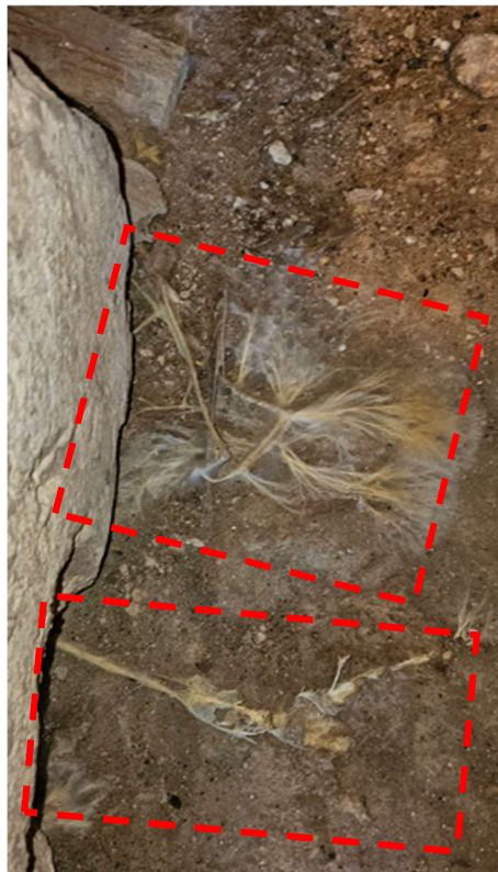
Fotografia 18 Widoczne bytowanie strocza domowego. Sznury grzybniowe, które stopniowo obniżają wytrzymałość drewna – posadzka w lapidarium.
