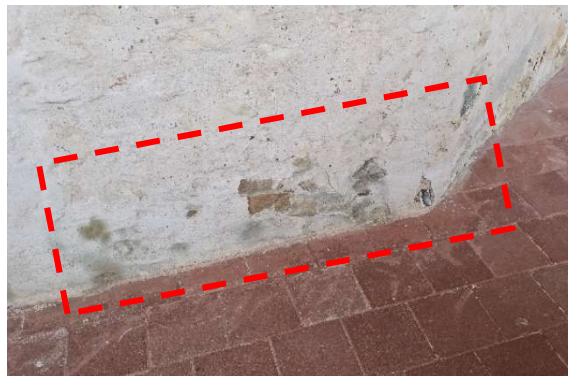
Fotografia 14 Widoczne popękania i ubytki tynku – krużganki.
